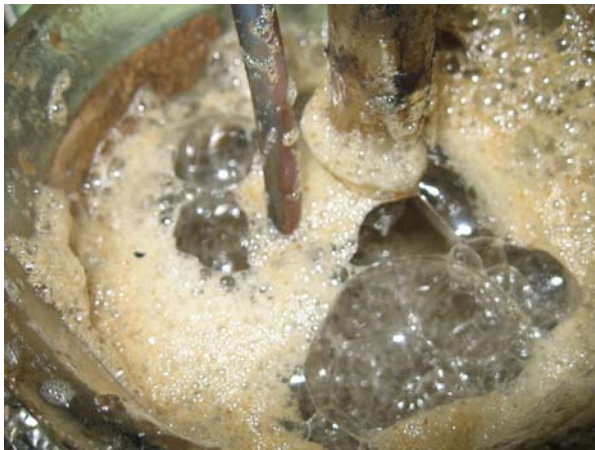
Bild 4.6 Schaumbildung auf dem belüfteten Becken der EMa-Anlage führte zum Austrag von Belebtschlamm
